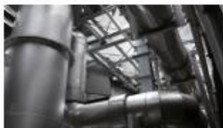
プラント配管
