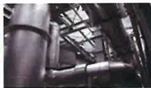
プラント配管
