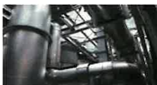
プラント配管
